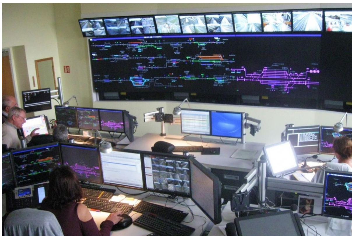
Obrázek 57 – Správa železnic, Centrální dispečerské pracoviště Přerov
