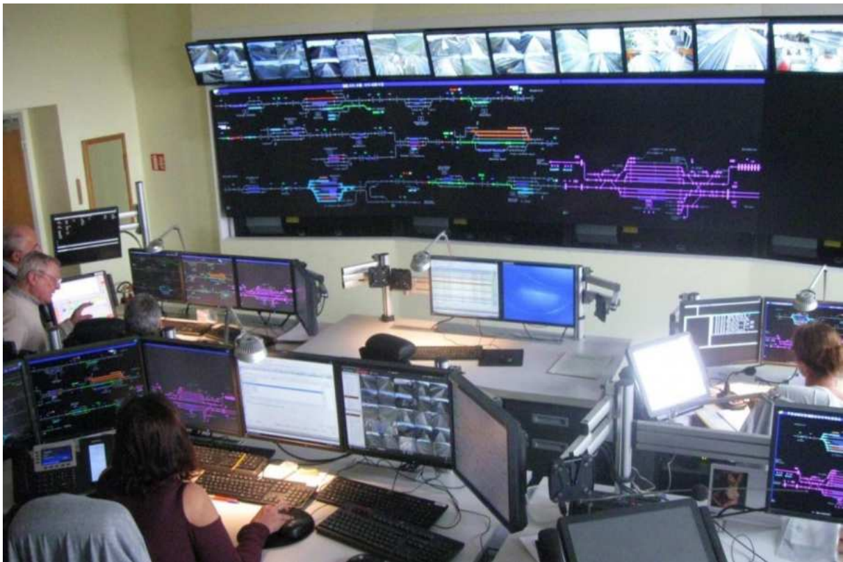
Obrázek 57 - Správa železnic, Centrální dispečerské pracoviště Přerov
